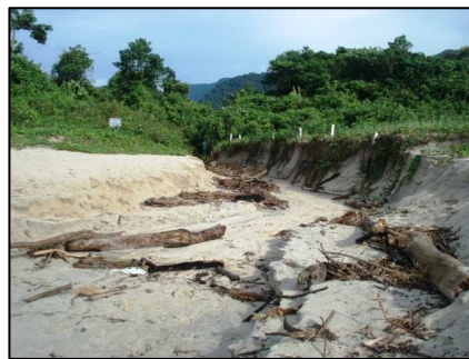
Erosão pela chuva em um dos acessos à praia
